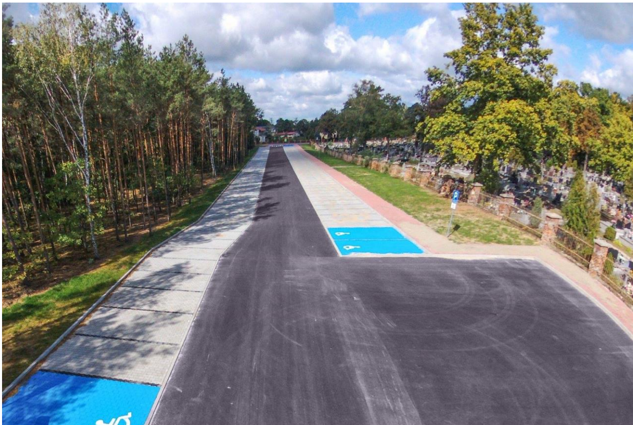
Droga gminna wraz z miejscami postojowymi przy cmentarzu w Rudniku nad Sanem
