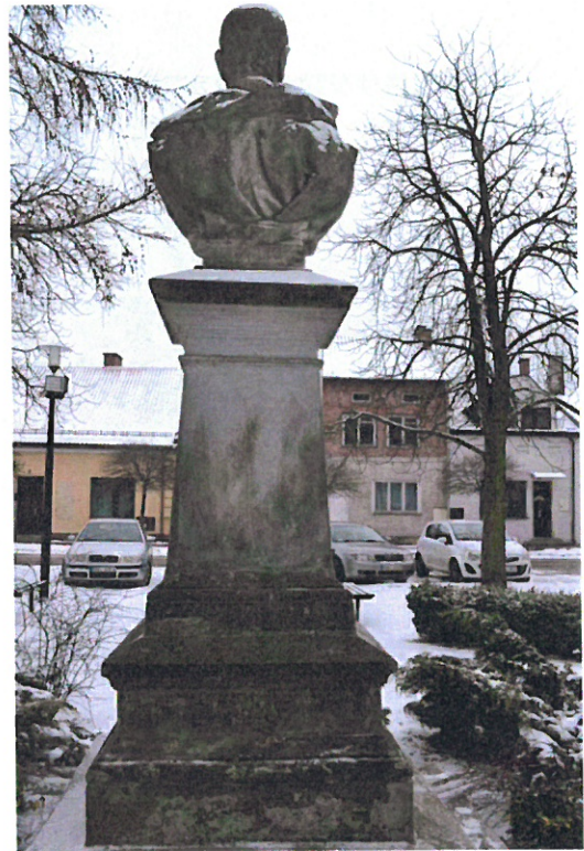
Fot. 4 Pomnik Ferdynanda Hompescha na placu centralnym rynku w Rudniku nad Sanem. Widoczny zły stan zachowania postumentu. Powierzchnia kamienia i tynku jest silnie zabrudzona, porośnięta mchami i porostami. Widać uszkodzenia piaskowca spowodowane czynnikami zewnętrznymi.
